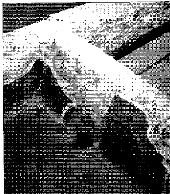
Fig. 11. Detalle del desagüe de la piscina occidental del frigidarium que comunica con la latrina (foto, V. García-Entero).
